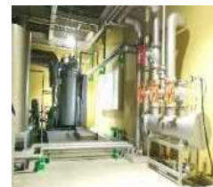
蒸気ボイラー
