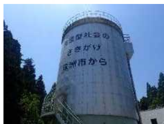
メタン発酵槽
