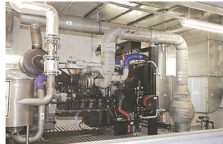
ガスを利用して熱・電気を供給
